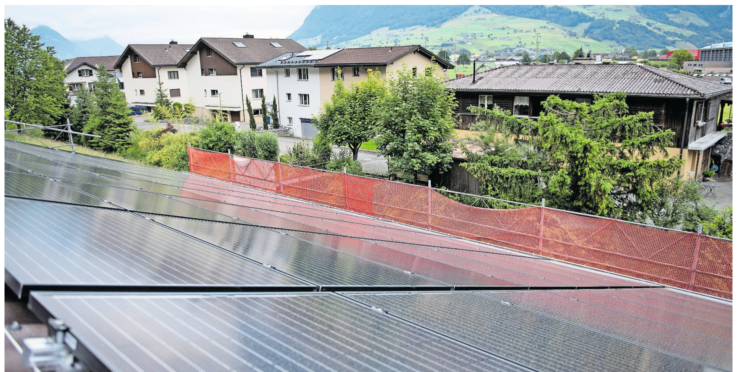
Eine Solaranlage auf einem Stanser Hausdach.
