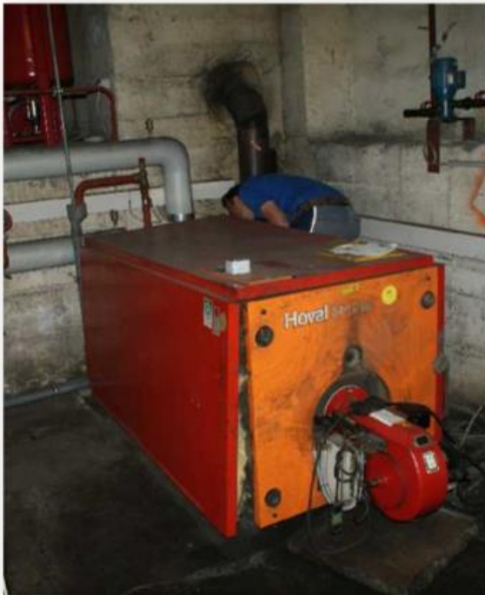
Quelle: Kurs der Kantone Luzern/Aargau „Heizungs-Check“
