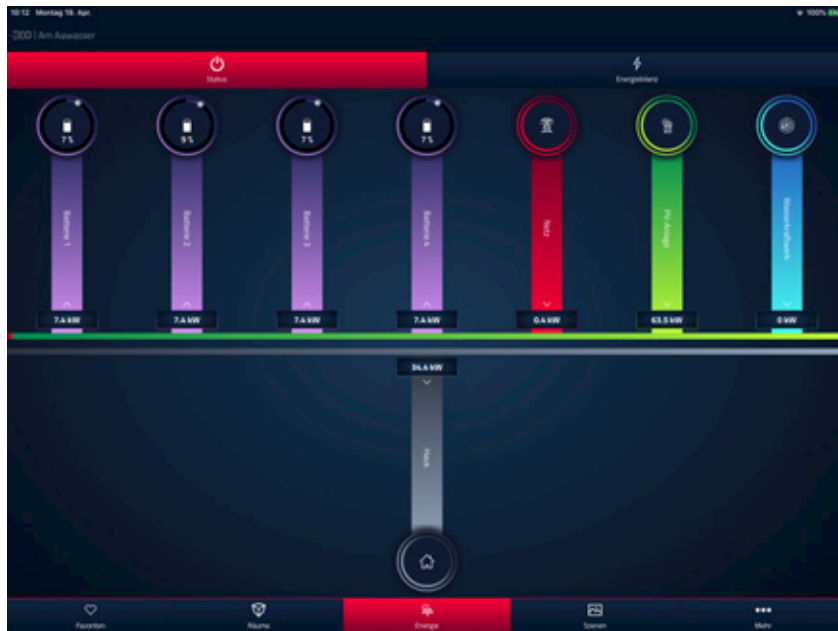
Messung der Energieherstellung, Bezug vom EWN und Energieverbrauch Ennetbürgerstrasse 34 - 38
