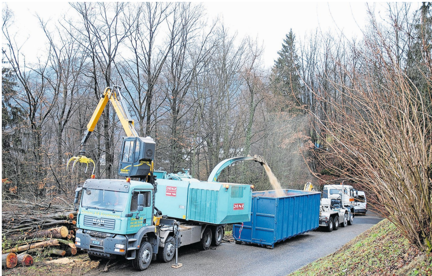
Im Raintobel wird geschlagenes Holz als Holzschnitzel verarbeitet und im Wärmeverbund Grossmatt verheizt.
