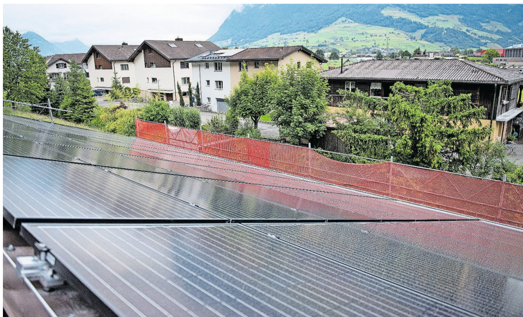
Eine Solaranlage auf einem Stanser Hausdach.
