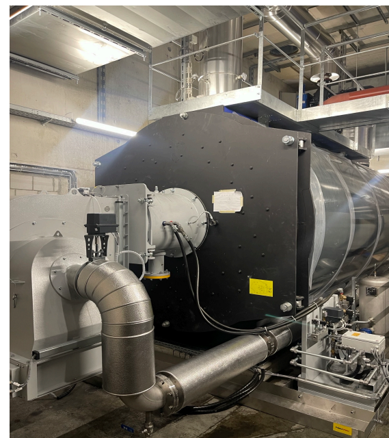
Ölkessel Ygnis 6.0 MW
